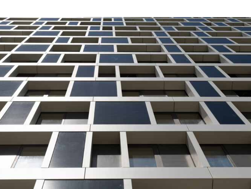
PV-panelen voorzien in het grootste deel van de energievraag van het gebouw. Vorsselmans zocht een zeer slank profiel, waarin deze panelen en de gevelbekleding geïntegreerd konden worden.
